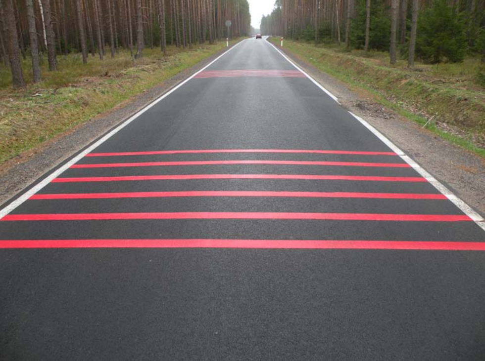
Fot. 27. Pasy akustyczno-wibracyjne na nawierzchni drogi przechodzącej przez Bory Dolnośląskie (© S. Nowak)
